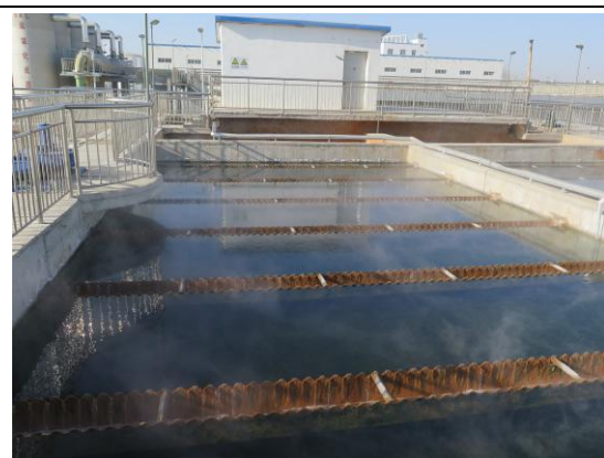
污水处理站深度处理池
