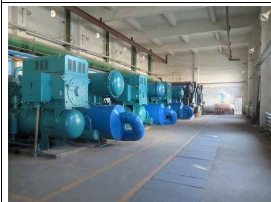
技改冷冻站设备
