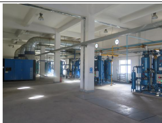
新增空压氮气站
