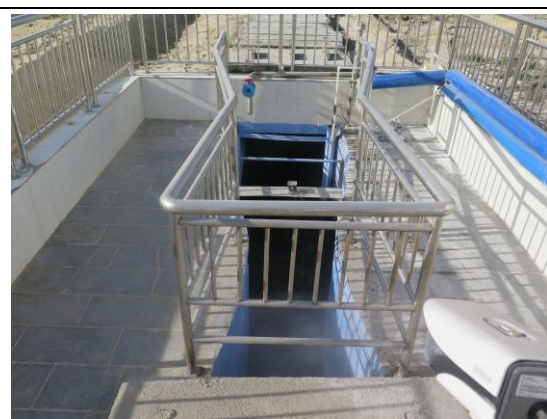
全厂废水总排口及在线监测设备设置位置
