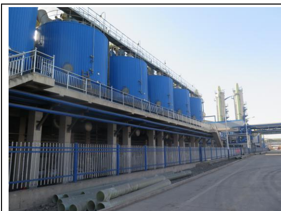
现有废气回收站（活性炭吸收槽）
