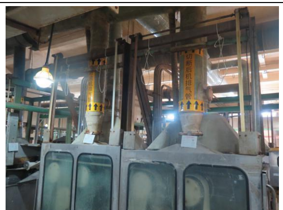
纺炼车间切断工序废气集中收集管道
