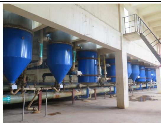
纺炼车间给纤槽废气 (CS 2 ) 冷凝回收装置
