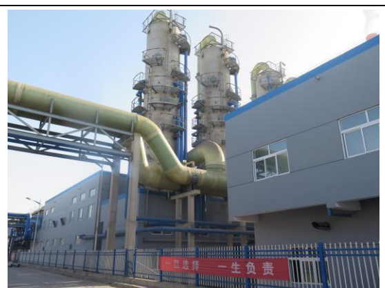
现有废气回收站（碱洗槽）
