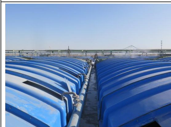
污水处理站生化曝气处理池及恶臭防护设施
