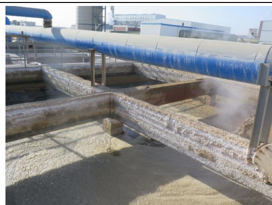
废水处理设施
