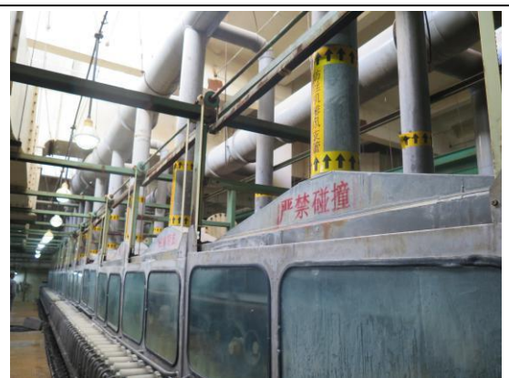
纺炼车间纺丝机废气集中收集管道
