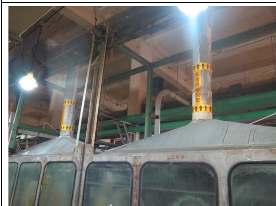
纺丝车间牵伸工序废气集中收集管道
